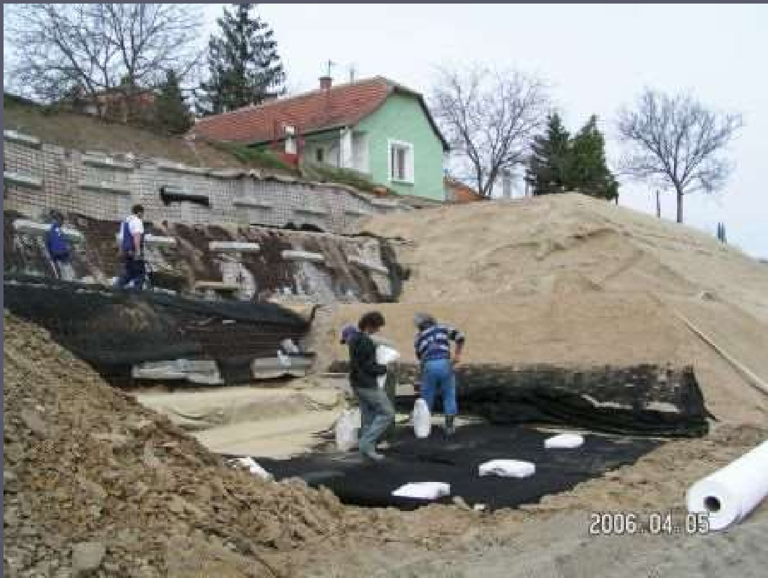
Ercsi támfal készítése a 2006-ban bekövetkezett omlás után (fotó: Sycons Építőipari Kft.)
